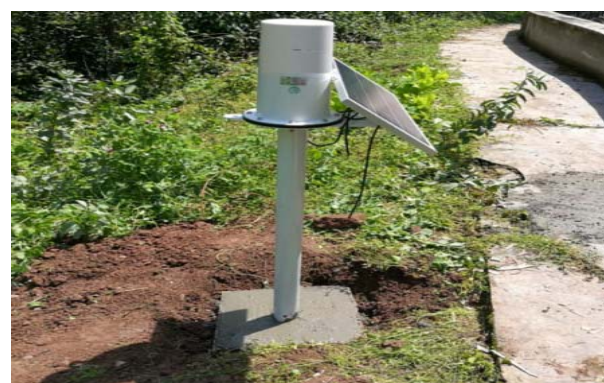
图5 地裂缝监测仪安装图
