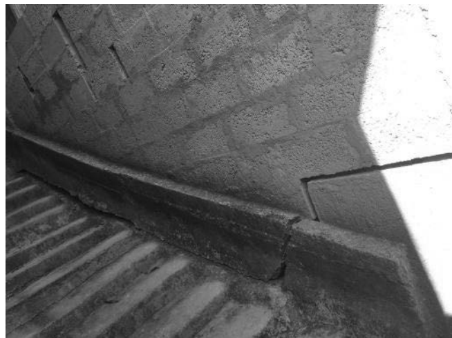
图1 勘查区民房基础拉裂缝示意
